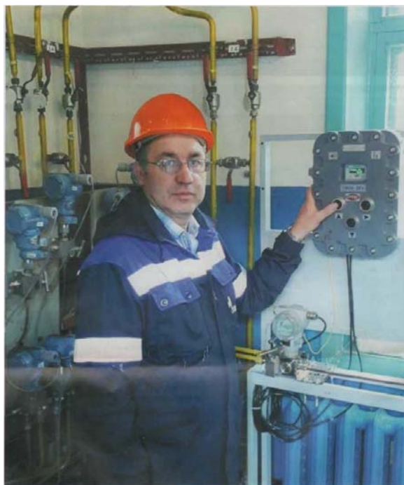
Владимир Окулов и его коллеги подсоединили взрывозащищённый контроллер без проведения огневых работ
